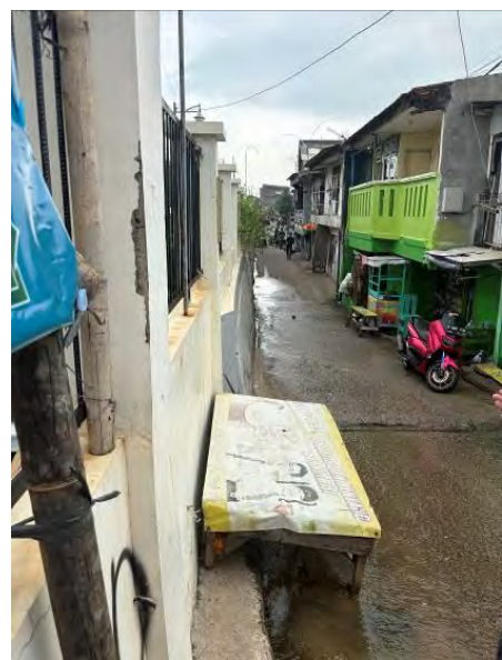
（写真）地盤沈下が顕著なエリア
