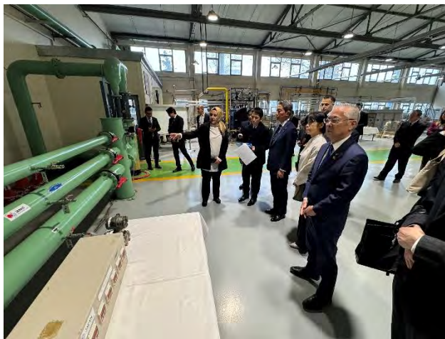
(写真) 国立省エネルギーセンター内の設備
