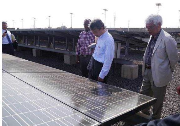
（写真）日本から供与された研究所内の太陽光パネル
