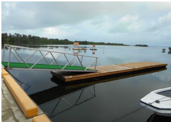
（写真）ペリリュー北港に設置された浮き栈橋
