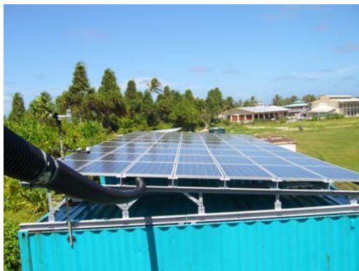
（写真）競技場の客席上の太陽光パネル
