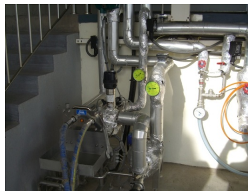
牛乳工場前の生乳注入用バルブ
