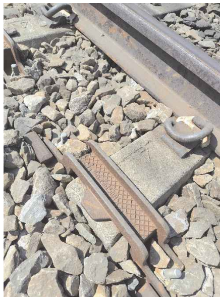
（写真）座屈防止板
