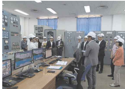
(写真) 1-6号機のオペレーションルーム
