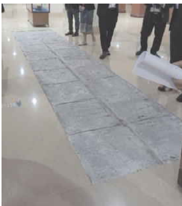
(写真) はがれた床タイル
