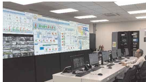
(写真) オペレーションルーム
