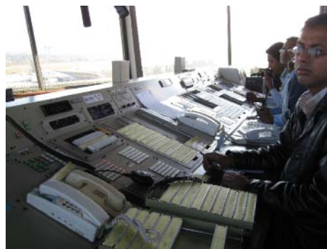
（写真）供与された管制塔の機材
